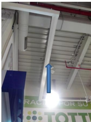
Tubería colgante Zona de Tottus.
